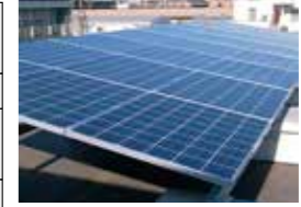
▲太陽光発電設備
